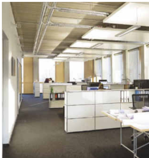
Offene Raumstrukturen: Deckensegel dienen zur Temperierung sowie zur Aufnahme von Akustikpaneelen und Beleuchtung.
